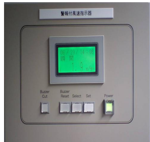
運輸指令所内の風速監視装置
