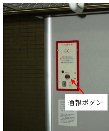
車内非常通報器
