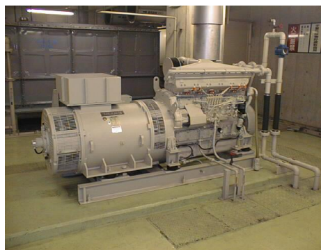
非常用発電機
