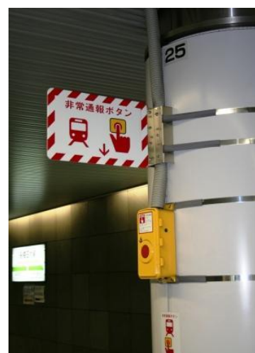
非常通報ボタン
