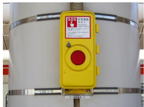
非常通報ボタン
