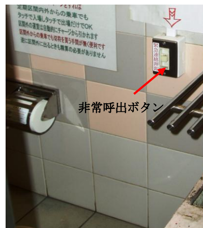
女性用トイレ「非常呼出ボタン」
