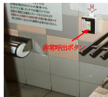
女性用トイレ「非常呼出ボタン」
