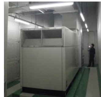
非常用発電機
