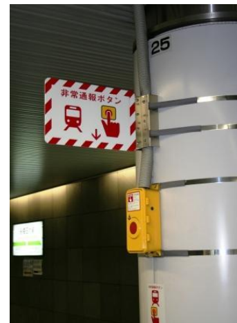
非常通報ボタン
