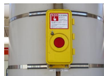
非常通報ボタン
