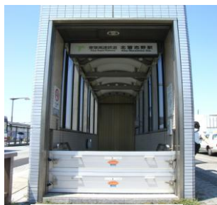
駅出入口の止水板
