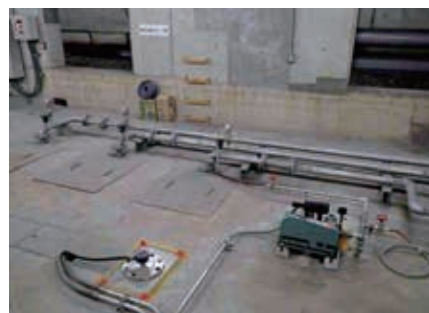
(排水設備・非常用排水ポンプ)
