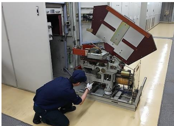
変電所内の遮断器の点検
